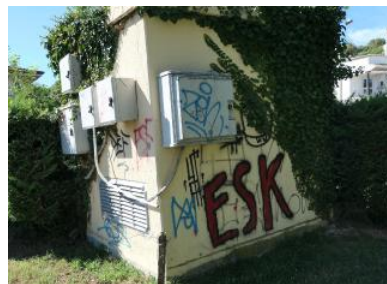
Zona Pastore Gli imbrattamenti dello stabile nel parco
