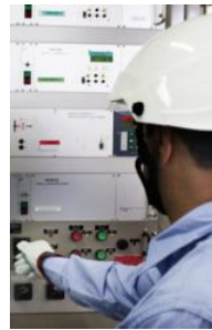
Operaio in una cabina elettrica
